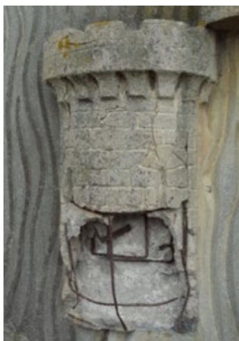
Figure 8 : Epaufrure liée à la corrosion des armatures. Gare de Dinan (22)
