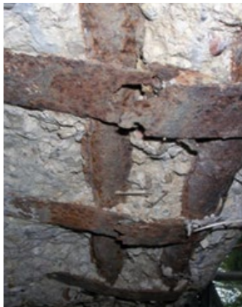
Figure 7 : Corrosion des armatures ayant entraîné la rupture des étriers Hennebique. Pont Camille de Hogues à Châtelleraut (86).
