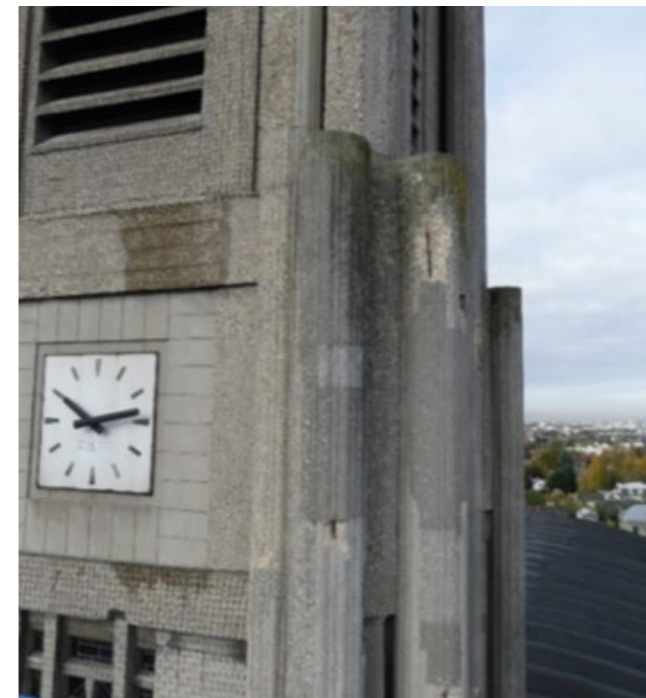
Figure 12: Clocher de l'église Notre Dame de la Consolation au Raincy (93), construite en béton armé par Auguste Perret. Malgré une importante campagne de restauration en 1991 (réparations en gris foncé), en 2019, la corrosion des armatures métalliques a de nouveau entraîné une altération des bétons.
