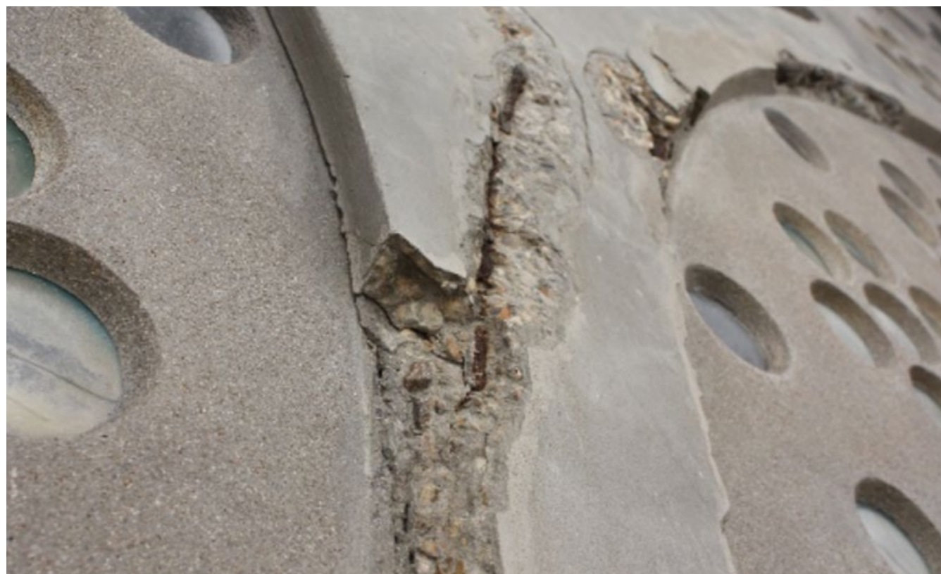
Figure 11: La corrosion des armatures a conduit à d'importantes pertes de matière sur l'ossature en béton de la baie occidentale de l'église Saint Louis de Vincennes (94).
