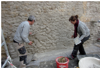
La première couche de corps d'enduit de chaux (NHL 3,5) appliquée en «jeté truelle»
