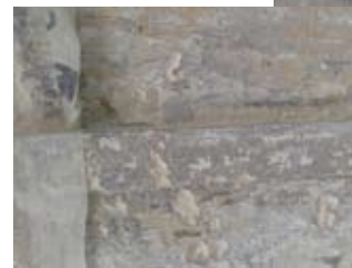
Etat des surfaces après essais...
