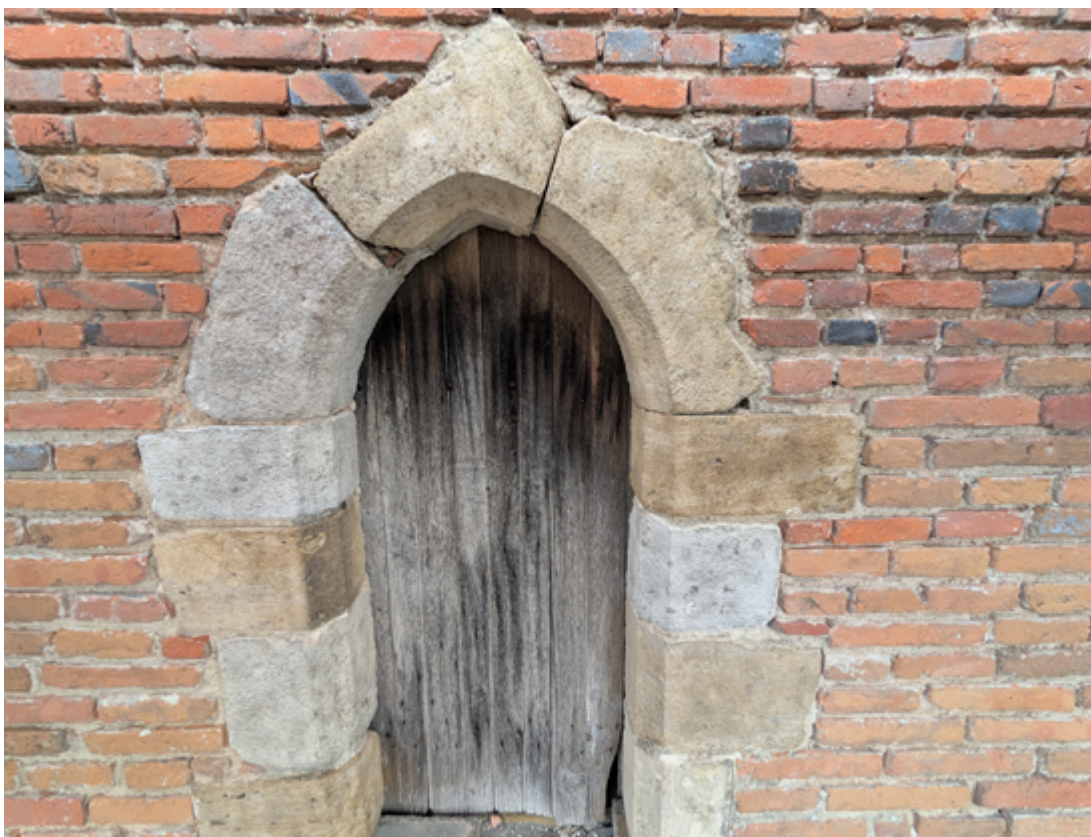
État avant restauration des briques et de la porte du pignon du transept sud, mars 2025.
