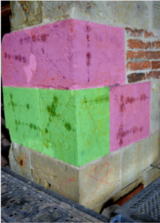
LACHALADE, CONTREFORT G, BLOCS DE PIERRE TÉMOINS
