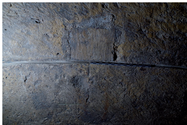
Fig. 2 : Chartres (Eure-et-Loir) cathédrale Notre-Dame, chapelle Saint-Piat : tourelle nord, rez-de-chaussée, trou de boulon surmontant un repère incisé et marque lapidaire. (T. Lacroere, Direction de l'archéologie de Chartres métropole)
