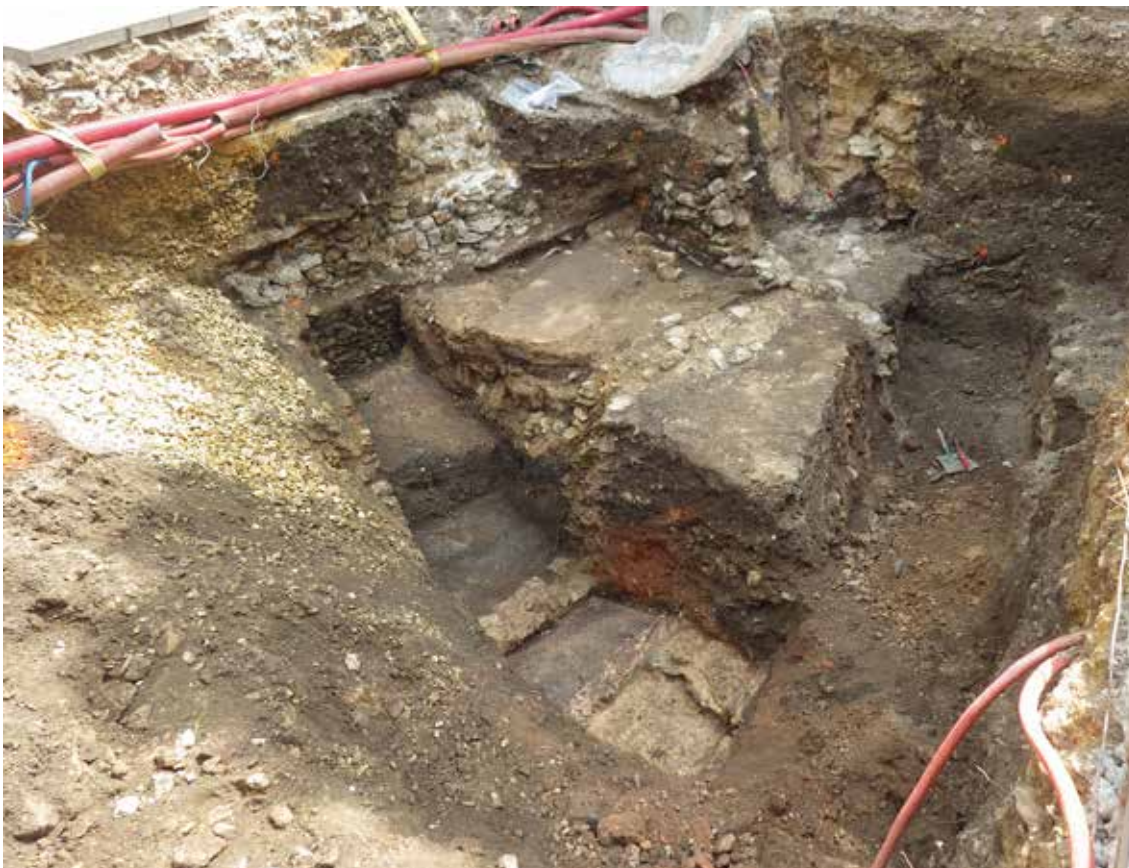
METZ, points d'apport volontaire enterrés (PAVE), rues Belle-Isle, boucherie Saint-Georges, places Gabriel Hocquard, Jean-Cocteau, Saint-Vincent et Saint-Martin Vue générale du PAVE de de la place Saint-Martin (cliché : Metz Métropole)
