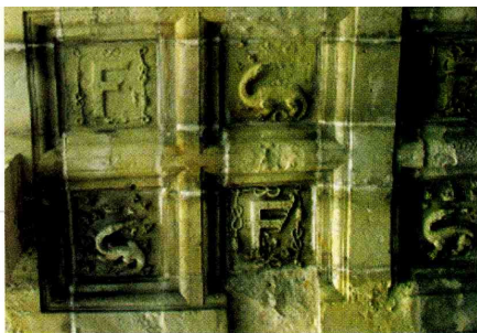
Ces quatre caissons subissent des altérations multiples dues à la cristallisation des sels contenus dans la pierre : efflorescences salines de couleur blanche, désagréments sableux et alvéolaires, défilage
