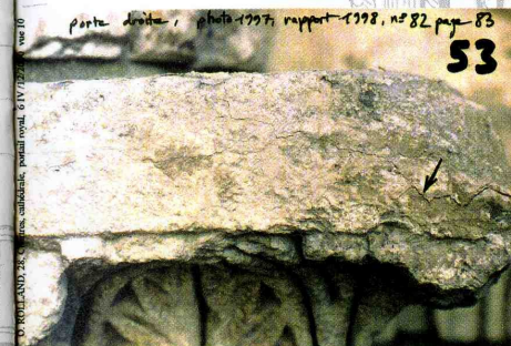
La fissure s'est agrandie
