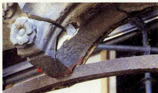
En maints endroits, les éléments métalliques contenus dans la rose ont fait éclater la pierre en s'oxydant.
