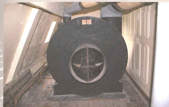
La turbine du ventilateur sous les combles.
