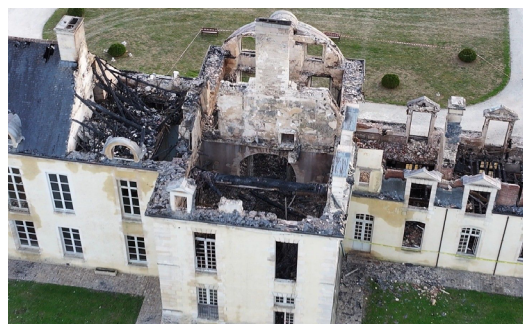
Chateau de Médavy après l'incendie de septembre 2025 © Fondation du patrimoine
