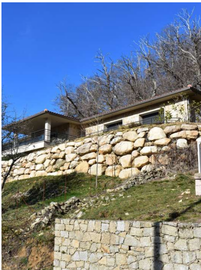
En avant plant : ouvrage de soutènement en béton avec placage en pierre disposée en opus incertum et barbicanes, s'inscrivant dans le patrimoine local. En second plan : ouvrages de soutènement avec enrochement cyclopéen à proscrire.
