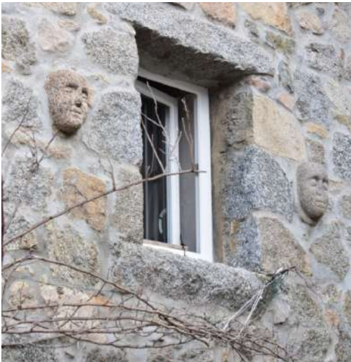
Ci-dessus : à Boccialacce, pierres sculptées dans le quartier de Vassalacci sur l'une des plus anciennes maisons. La menuiserie traditionnelle a été remplacée par une menuiserie en PVC ou aluminium blanc qui ne s'accorde pas à son environnement patrimonial.
