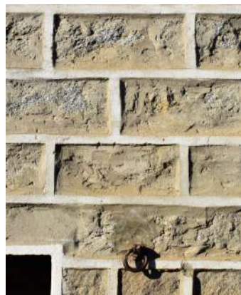
Mur en blocs de granit taillés posés sur assises régulières. Le choix d'un enduit à pierre-vue a privilégié une pose avec joints en saillie ( finition non souhaitable).
