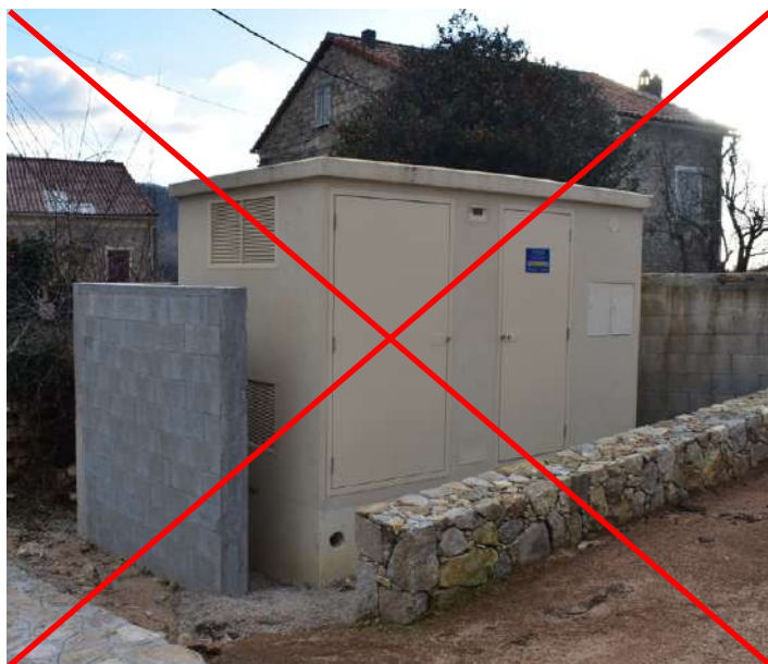
Dans ce cas, à Dominicacci, les maçonneries encadrant le volume technique ne présentent pas de hauteur suffisante. L'absence de toiture à versant porte également préjudice à son inscription patrimoniale.
