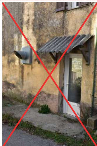
A Tricolacci, évacuation des fumées par un conduit aménagé dans la façade. La proportion de l'ouvrage doit rester mesurée afin de mieux s'intégrer.
