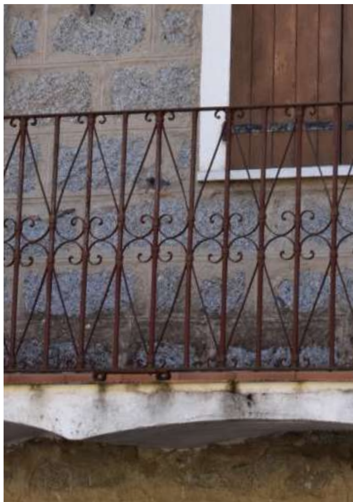
Garde-corps de balcon rouillé
