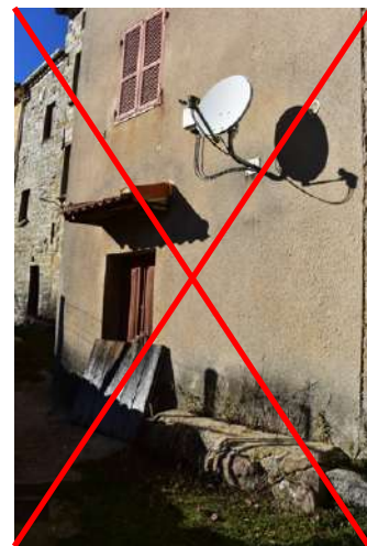
A Costa, parabole sur la façade fortement visible depuis l'espace public et nuisant au patrimoine bâti.
