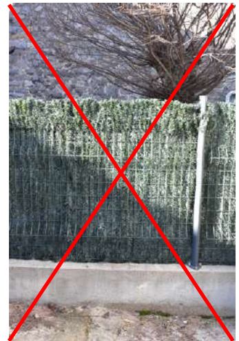
A Santu : parapet en béton enduit au ciment surmonté de grilles préfabriquées avec parois occultantes en plastique imitant la végétation. Cas type de clôture à éviter car non patrimoniale et en visuel direct avec l'espace public.
