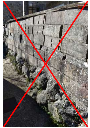
A Tricolacci, exemple de clôture en blocs béton portant préjudice visuellement au patrimoine du quartier. Outre les questions de stabilité que cet ouvrage interroge, l'absence d'enduit et de couronnement décontextualise la construction. Ce cas n'est pas inintéressant au regard de son implantation surmontant un ancien mur en pierre qui pourrait lui-même être valorisé par un enduit lisse sur les parties en béton, qui progressivement ferait apparaître les pierres en partie basse.
