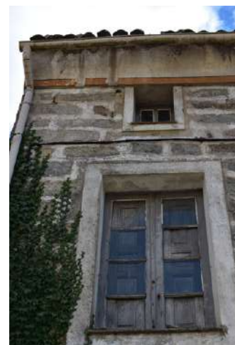
Corniche à la génoise soulignant le débord de toiture. Gouttière PVC non traditionnelle.
