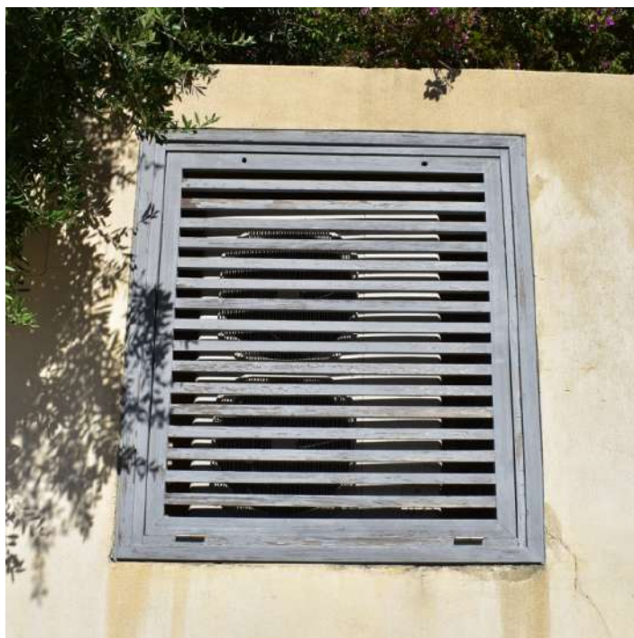
Exemple d'un volet en bois à persiennes mis en oeuvre pour l'occultation d'un équipement encastré en façade (exemple à Lumio)
