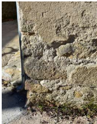
Chute d'enduit inhérent aux remontées capillaires en pied d'immeuble.
