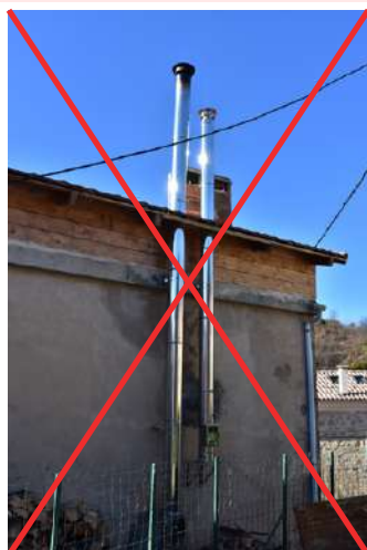
A Santu, l'installation de conduits de poêle ou de cheminée en saillie des façades est à proscrire. La finition brillante sera également à éviter.
