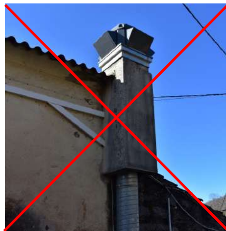
Conduit en maçonnerie mixte : métal et béton présentant une souche avec formes complexes non traditionnelles.
