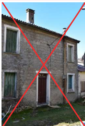
A Stazzona, conduit en saillie de la façade d'une construction.
