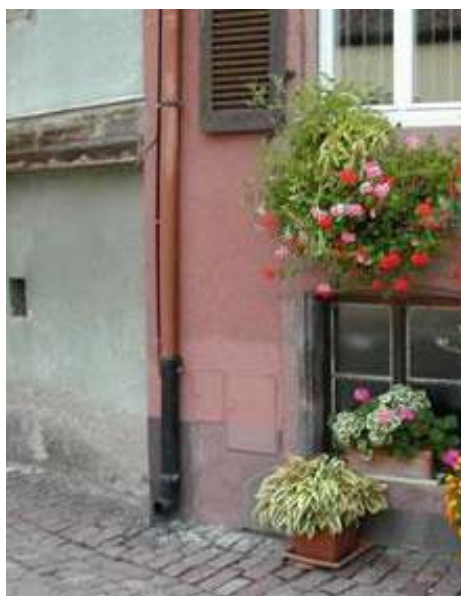
Exemple d'un coffret EDF encastré dans le mur et peint
