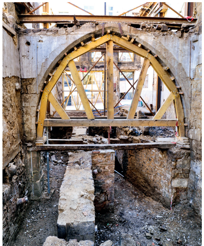
LIMOGES, 30-32 rue Elie Berthet - Arc médiéval mis en sécurité par un boisage, vue vers la rue (cl. E. Balbo, mire 50 cm)
