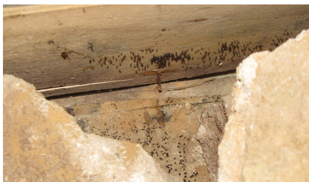
ill. 37 : développement de moisissures sur des cagettes stockées dans un dépôt trop humide, 2013. Cliché S. Groetembril.
