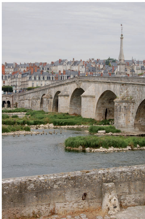
37 /// Pieux du pont provisoire au-devant du pont en 2015. Les batardeaux contournent les deux piles plus blanches.
