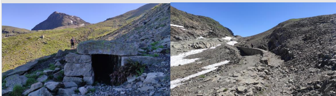
Ouvrages en pierre sur le canal de Malcros, Champsaur, Hautes-Alpes, © Alain Podda
