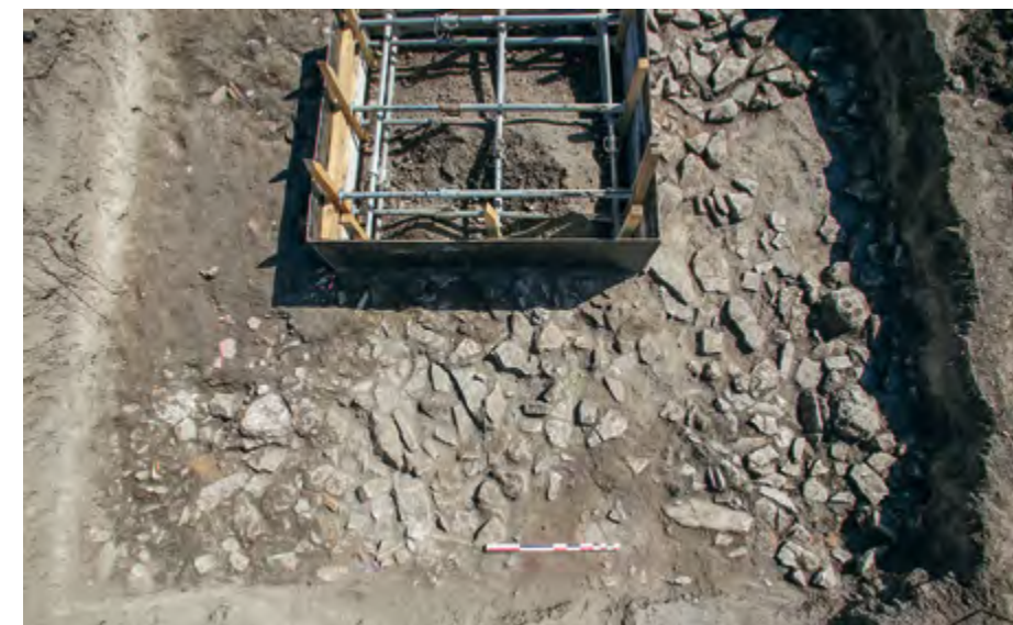
Fig. 161 – L'ISLE-SUR-LA-SORGUE, La Rode. Traces de démolition d'une construction rustique (cliché N. Fourchet/DPI).
