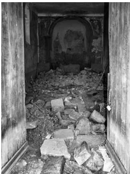
Fig. 4 – CÉRESTE, chapelle Saint-Georges. Vue vers l'est des dégâts dans la nef et dans l'abside (cliché M. Vivas / SDA-CG04).
