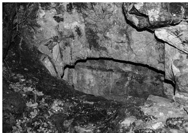
Fig. 163 – Aqueduc romain de Traconnade. Effondrement du piédroit et d'une partie de la voûte permettant l'accès au canal. L'aqueduc traverse ici un vallon dans une zone très escarpée (cliché B. Fino).
