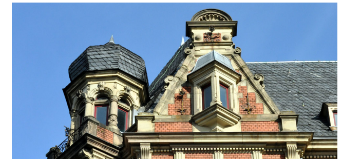
Couverture en ardoises «pose vieilles allemandes» sur une toiture de la fin du XIX e siècle © Région Grand-Est - Inventaire général
