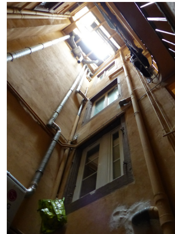
Les passages des réseaux et autres installations techniques dans les cours très enclavées, contribuent à réduire la qualité du cadre de vie ©Atelier G. André
