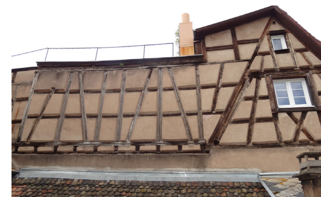
Enduit des remplissages du pan de bois présentant un débord trop important, exposant l'enduit aux ruissellements des pluies à l'origine de dégradations © Atelier G. André
