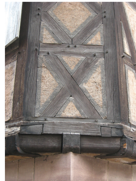
Enduit des remplissages au nu de la structure du pan de bois présentant des décors en filets © Bailly-Leblanc
