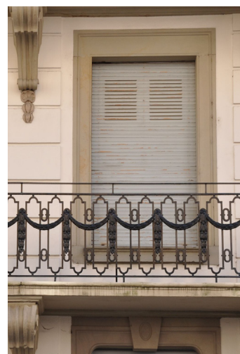
Volet roulant en bois du début du XX e siècle, présentant des jours en partie haute © Région Grand-Est - Inventaire général
