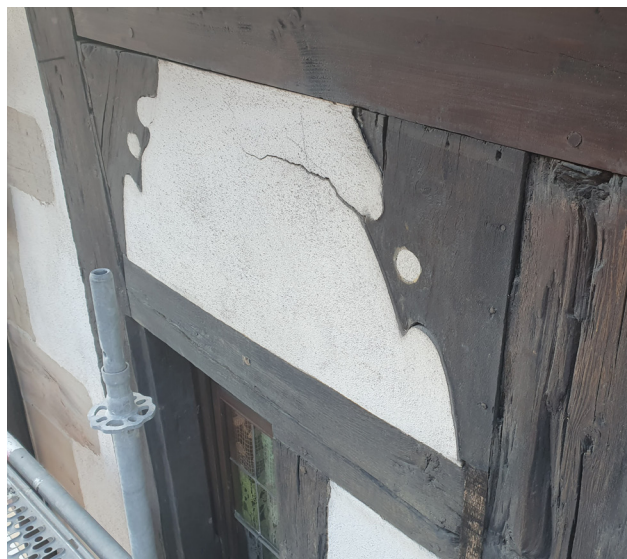
Fissuration de l'enduit hydraulique trop dur pour la structure en pan de bois © Atelier G. André
