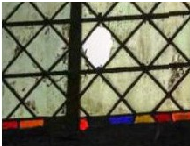
Exemple d'un vitrail endommagé Crédits photographiques : Manon CRUZ
