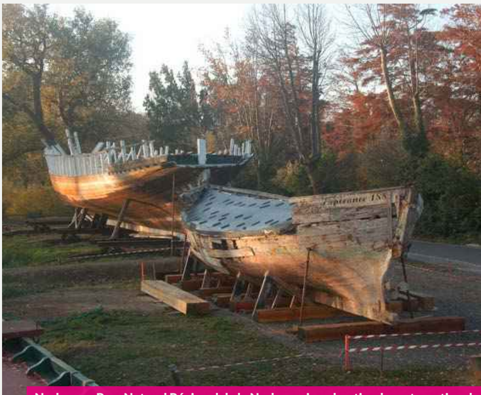
Narbonne. Parc Naturel Régional de la Narbonnaise, chantier de restauration du patrimoine maritime © Conservatoire maritime et fluvial des pays Narbonnais
