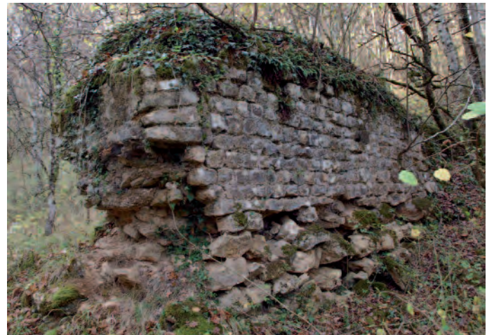
Aqueduc du Cimeau, mur bahut avec le départ d'une arche (propriété du château de Lamotte) (Cliché P. Arbona).
