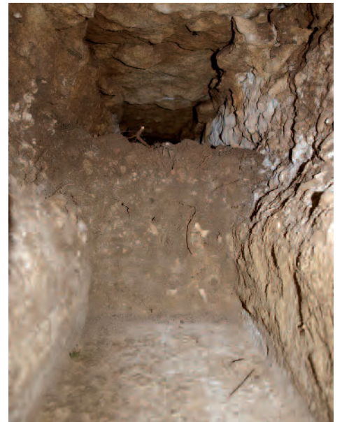
Ligugé, Bois de la Matauderie, Aqueduc du Cimeau, dégradation du conduit par l'eau (Cliché : P. Arbona).
