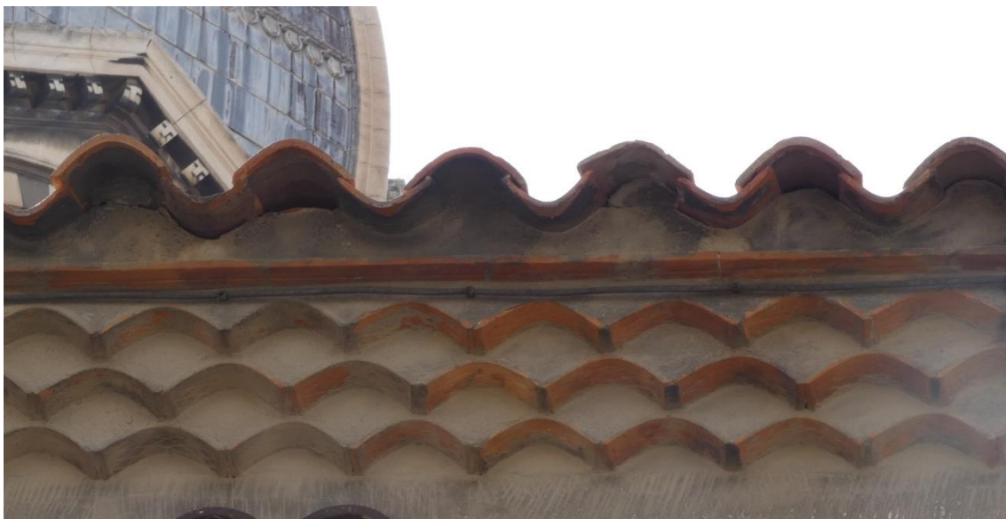
Anfractuosité localisée au niveau de la toiture de l'ancienne Major © G. Kapfer
