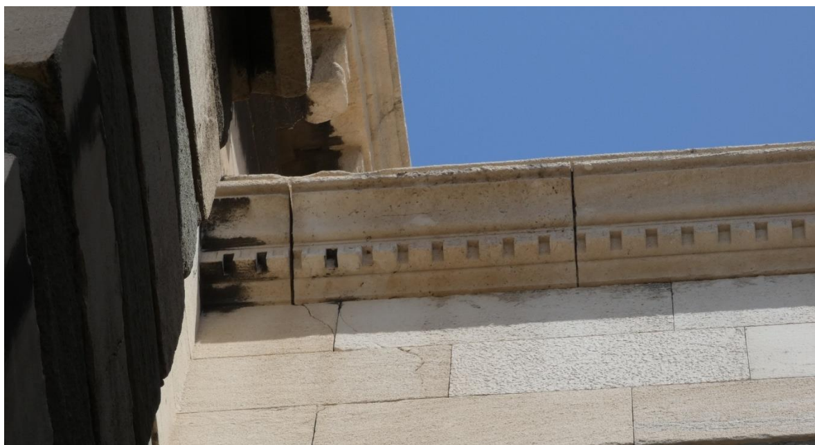
Exemple de disjointement entre des pierres, favorable aux chiroptères (face ouest) © G. Kapfer
