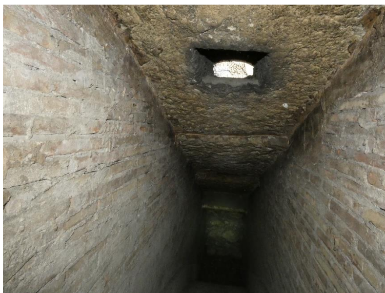
Ouvertures dans le grillage posé sur une aération (coursives entre les deux clocher) © G. Kapfer
