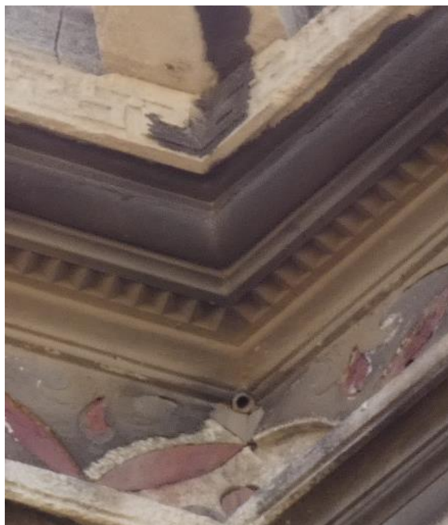
Trou d'évacuation (face est) © G. Kapfer
