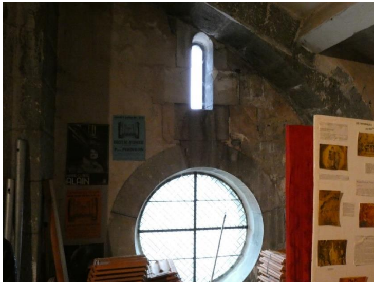
Vitres et grillages bloquant tout accès à la faune, étage N+1
