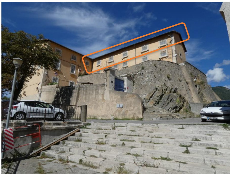
Maison d'arrêt à l'est de la cathédrale, nids d'hirondelles sous avancée de toiture © E. Huet-Alegre
