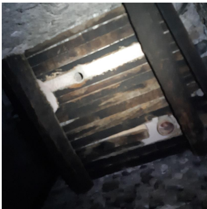
Plafond avec nombreuses fissures dans le bois. Au-dessus de l'escalier sur le premier palier © G. Kapfer
