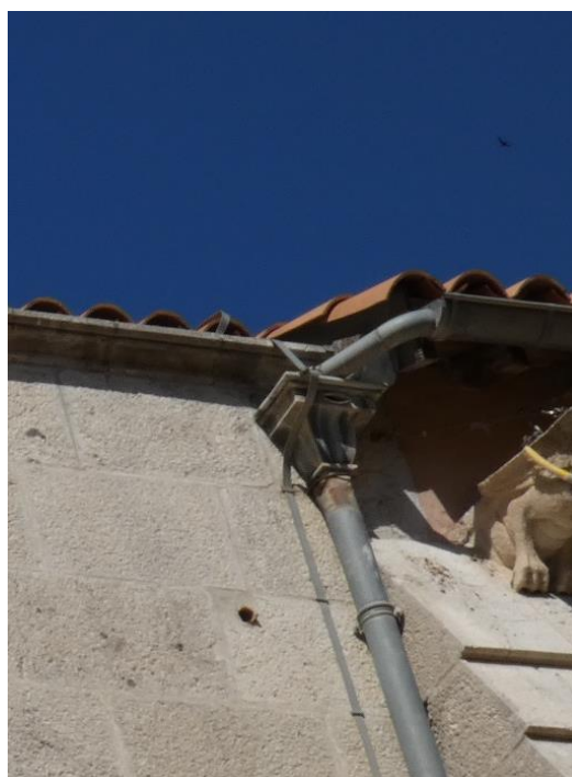
Espacements dans la toiture, drain en façade
