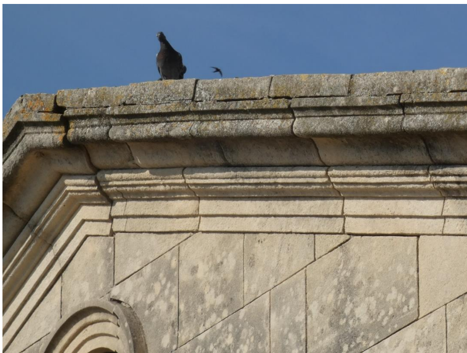
Disjointements sur le bâtiment © G. Kapfer
