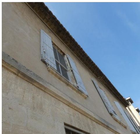
Espacement derrière les volets © G. Kapfer
