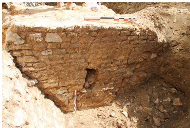
Falaise, Hôtel de Ville, fig. 3 : vue du parement ouest du mur de barrage de la douve (à gauche la contre-escarpe) (C. Billard).
