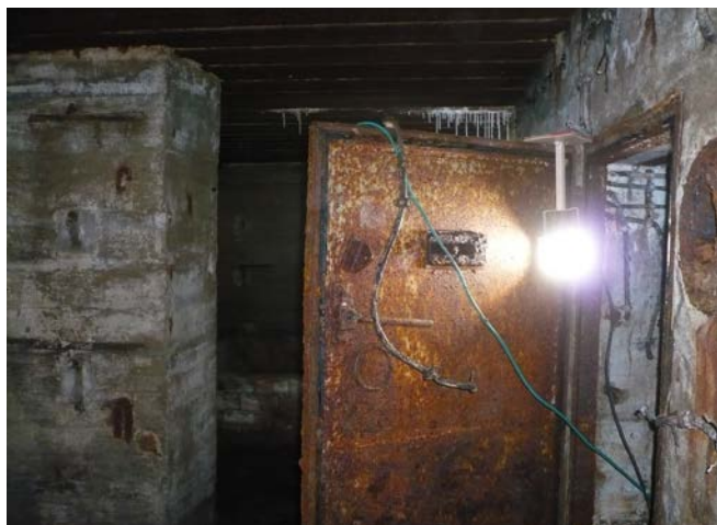
Dieppe, Neuville-lès-Dieppe, Cité Castors, fig. 3 : porte coupe gaz 19P7 en place (S. Mathieu).
