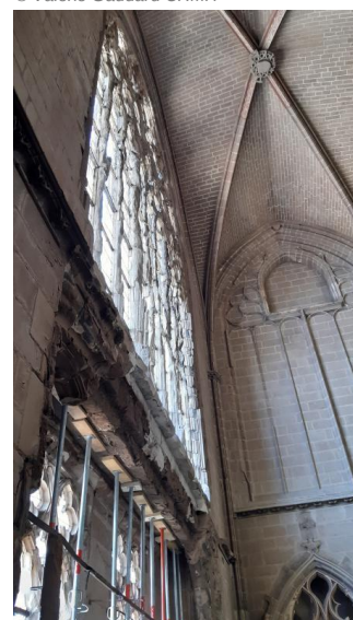
État des parements de la tribune
