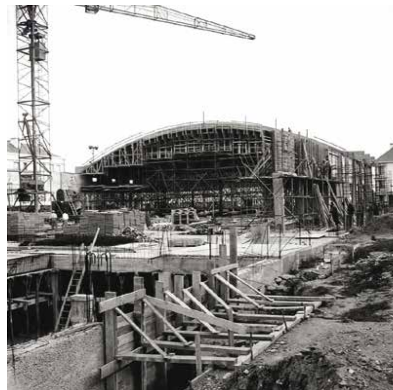
Halles de Saint-Nazaire, marché couvert en construction en 1957, collection Écomusée de Saint-Nazaire, fonds Lemasson, cl. Écomusée de Saint-Nazaire
