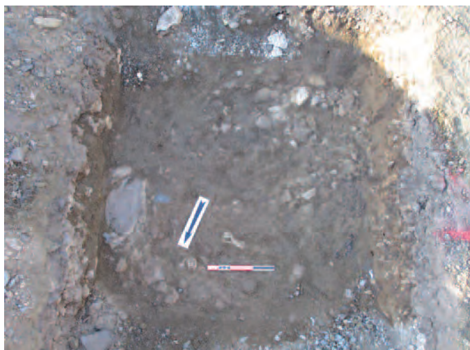
Thouars, voirie dans la rue Saugé, vue vers le sud (Cliché : D. Martins).
