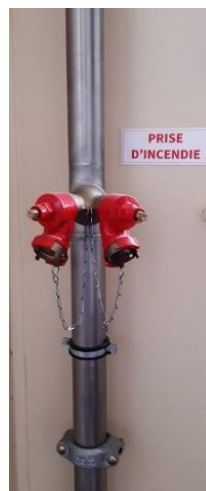
Colonne sèche dans une cage d'escalier, avec 2 raccords de refoulement
