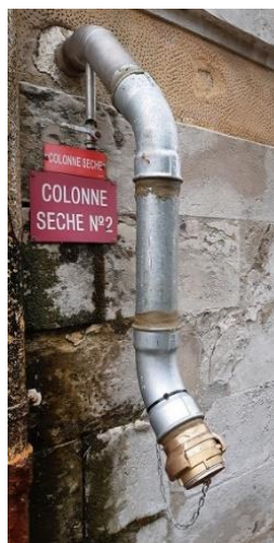
Raccord d'alimentation de colonne sèche en façade
