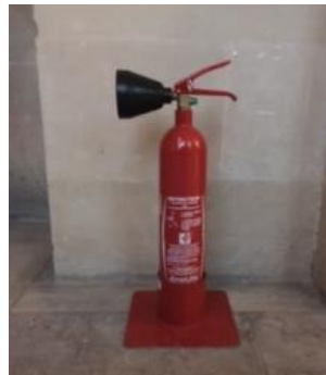
Extincteur CO2 sur socle
