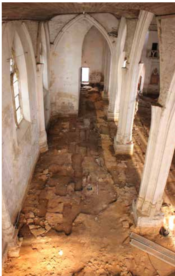
Fig. 125 - Vue vers l'ouest des structures de la nef sud ; à droite, le long des piliers, fondation du mur sud de la nef romane
