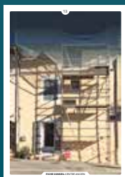
13 les modifications de baies
