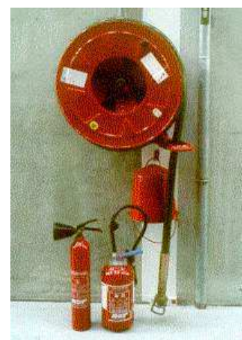
RIA et extincteurs
