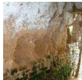
4 Présence de salpêtre en bas de mur
