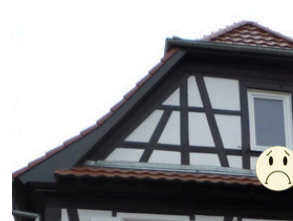
Pas d'habillage métallique
