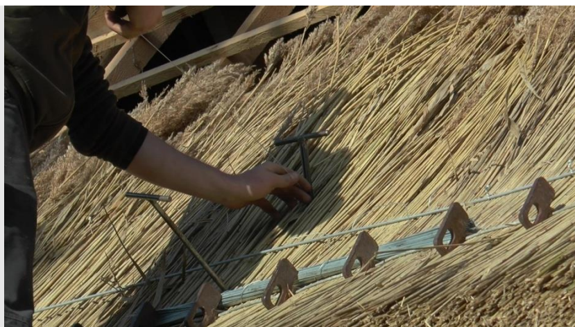
Ill. 31. Passage du fil de ligature dans la rainure de l'aiguille mâle. ©PNRGM. 2020
