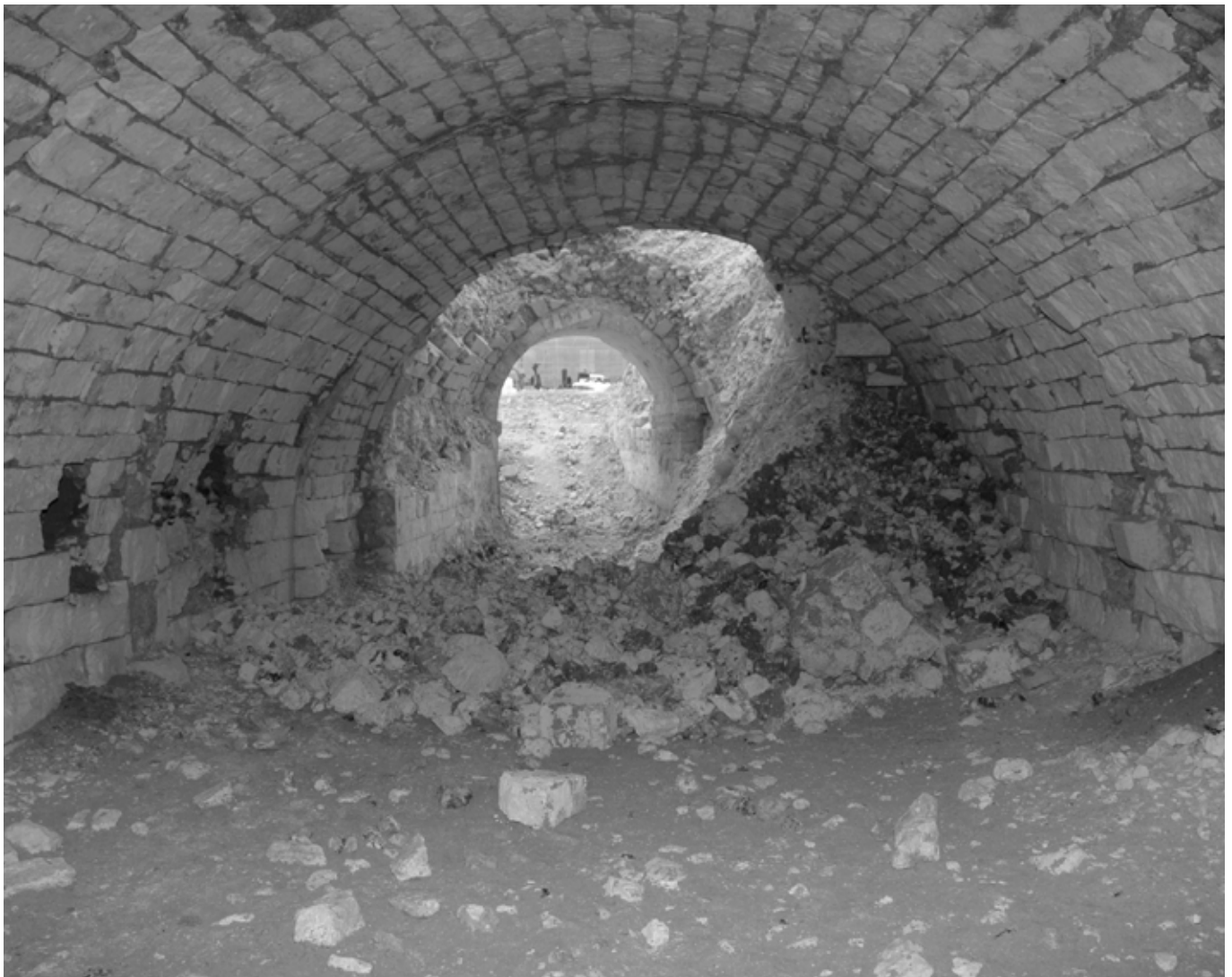
Gruchet-le-Valasse, Abbaye N.-D. du Vœu : Vue intérieure du cellier souterrain montrant une partie de la salle et le couloir d'accès partiellement effondré (É. Follain)
