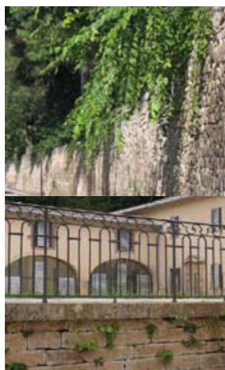
Présence de végétaux sur les murs
