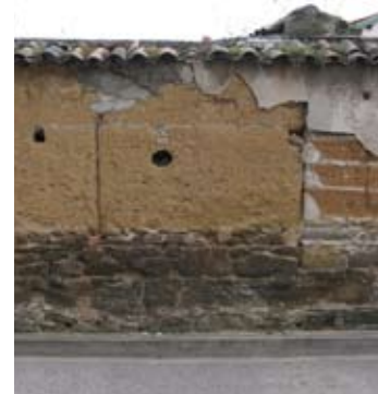
Décrochement des enduits
