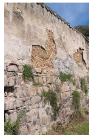
Combinaison des désordres
