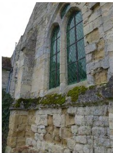
2016 • Vue de l'élévation Nord du transept. La pierre en calcaire jaune est très fortement altérée
