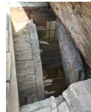
Détail de l'état de la structure de l'ancienne salle des mariages.
