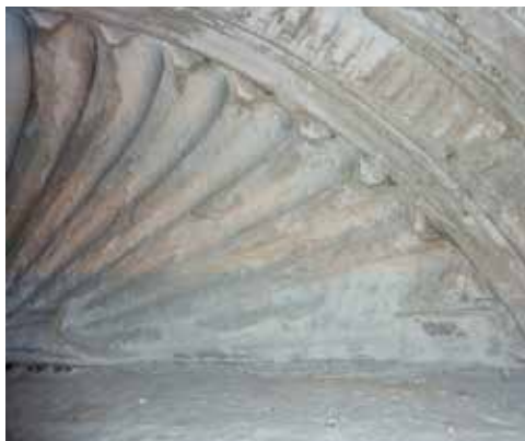
{fig. 1} État de dégradation du marbre avant dessalement, extrémité de la lunette de droite.
