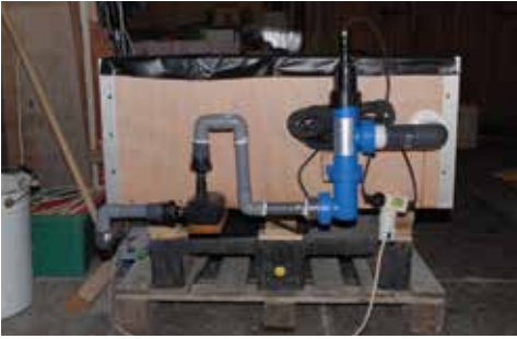
(fig. 3) Cuve de dessalement : la cuve de dessalement avec le système de circulation et désinfection de l'eau du bain.
