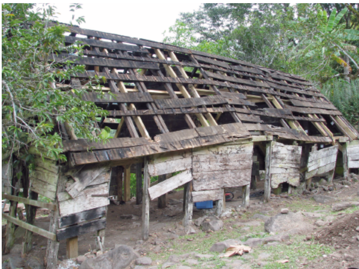
Figure 1 : VIEUX-HABITANTS, la Grivelière, case de travailleurs.
