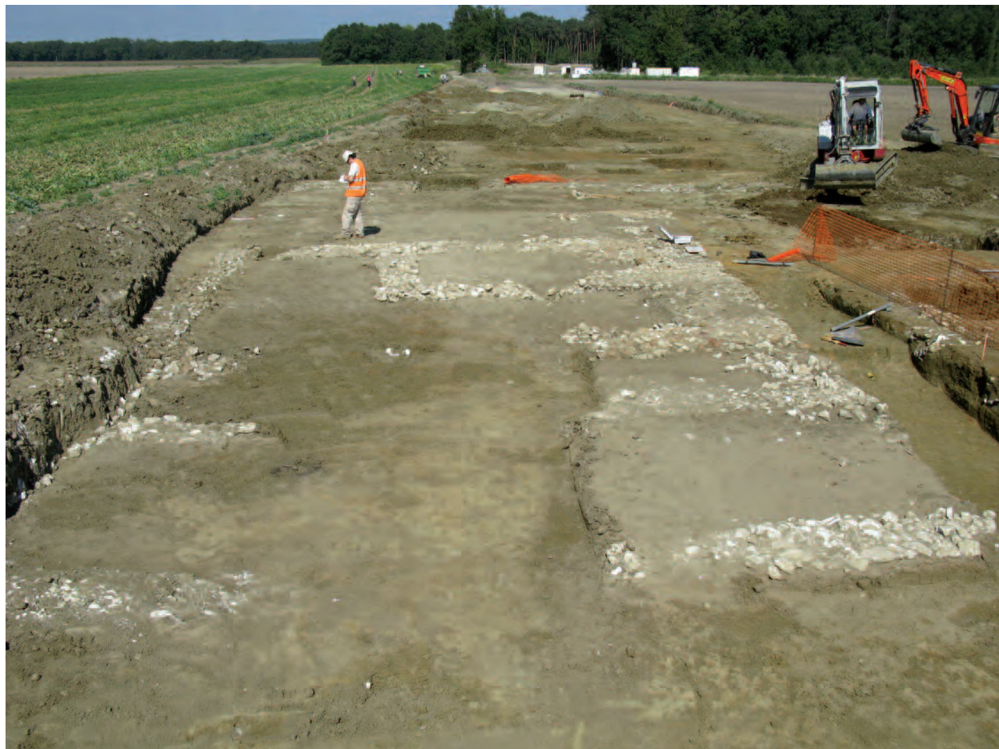
Les Trois-Moutiers, vue générale du chantier avec en premier plan le bâtiment antique (BAT 2) en cours de fouille (Cliché : INRAP).
