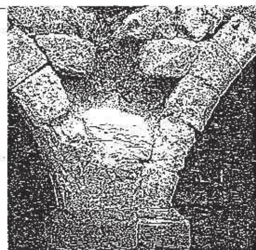
Le bâti dans l'intra-muros est parfois dégradé
