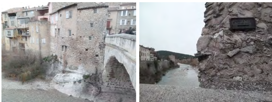
À gauche, le lit de l'Ouvèze, dont le niveau est monté au-dessus du pont romain, le 22 septembre 1992. À droite, le témoin de la crue au-dessus du pont.
