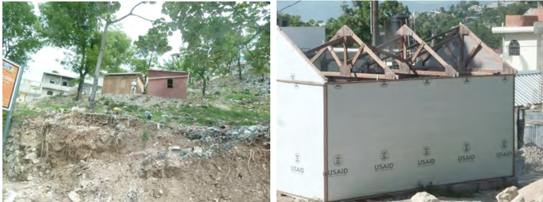
A gauche : T-Shelter monté en bord de route sur un terrain dont un pan vient de s'effondrer suite à de fortes pluies (Pétion-Ville). A droite : T-Shelter en construction estampillé du logo USAID (Port-au-Prince).
