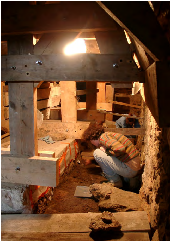
Démarrage de la fouille de deux sondages sous la tour, en amont de la reprise en sous-œuvre des murs-de-refend © Inrap.
