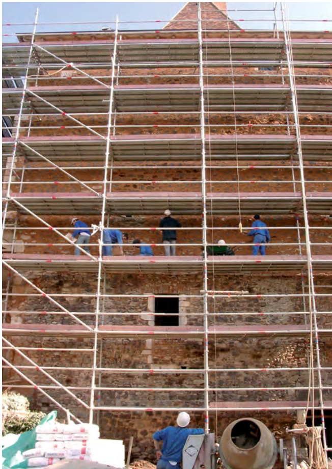
Avancement des travaux de restauration de la façade ouest de la tour © Inrap.
