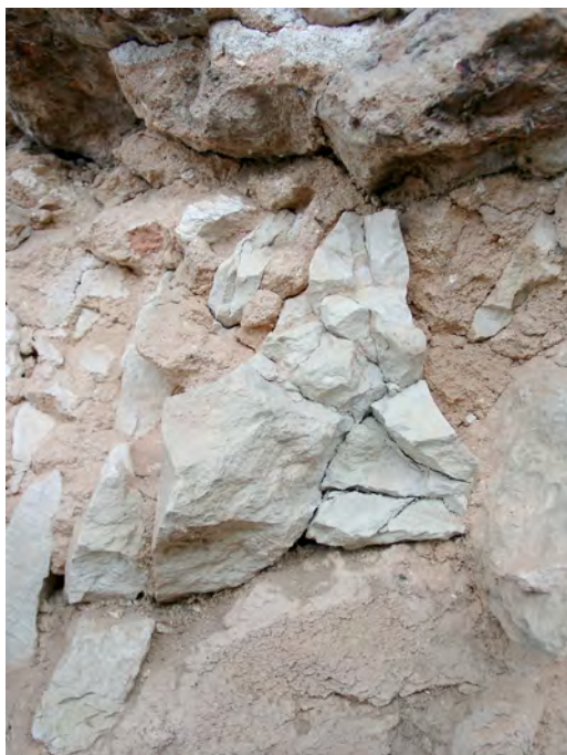
Remplage du XVI e siècle réemployé dans blocage maçonnerie nouvelle fenêtre © Inrap.
