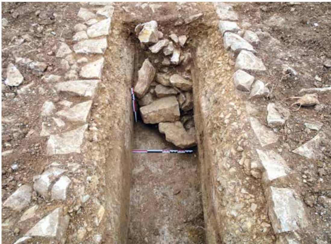
Saint-Germain-du-Puy, aqueduc de Nérigny, vue de l'effondrement de la couverture du conduit d'aqueduc au point de vue SPOT06 (Pierre Perrichon, Inrap)
