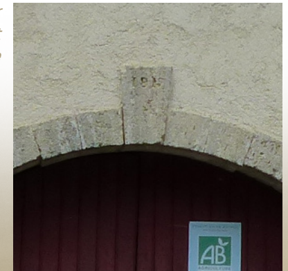
exemple d'un enduit simple sur façade agricole, mais qui met en valeur l'entourage en pierre
