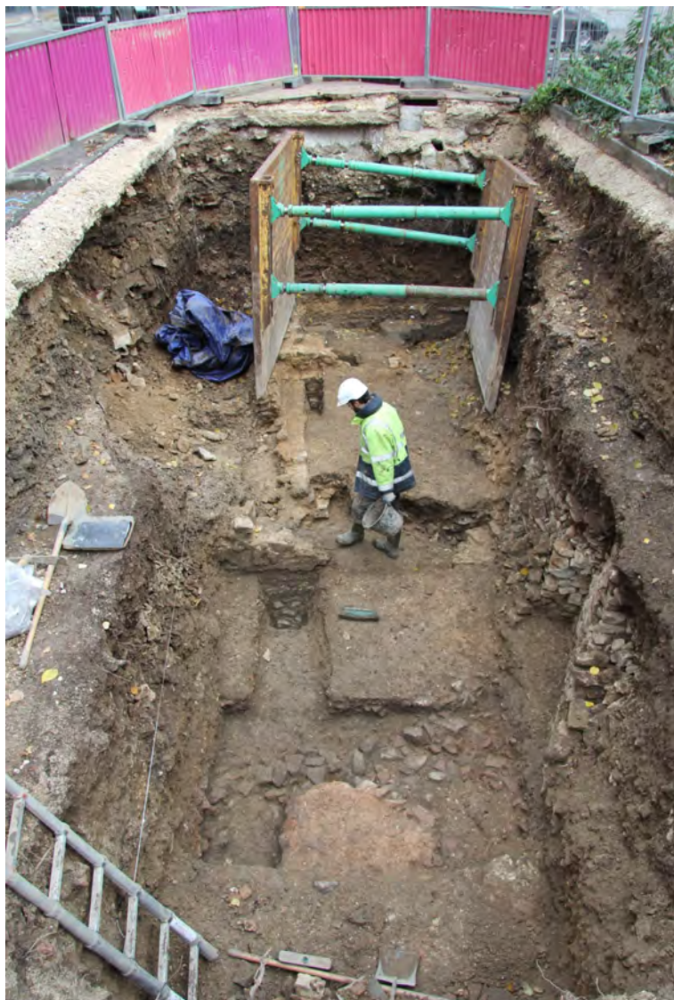
Fouille d'un point d'apport volontaire square Saint-Amour à Besançon. Aperçu des structures antiques de l'état 3. (© SCAP)
