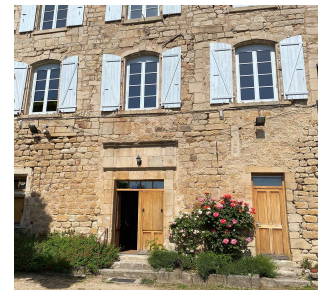
Végétation en pied de façade (Chassiers)
